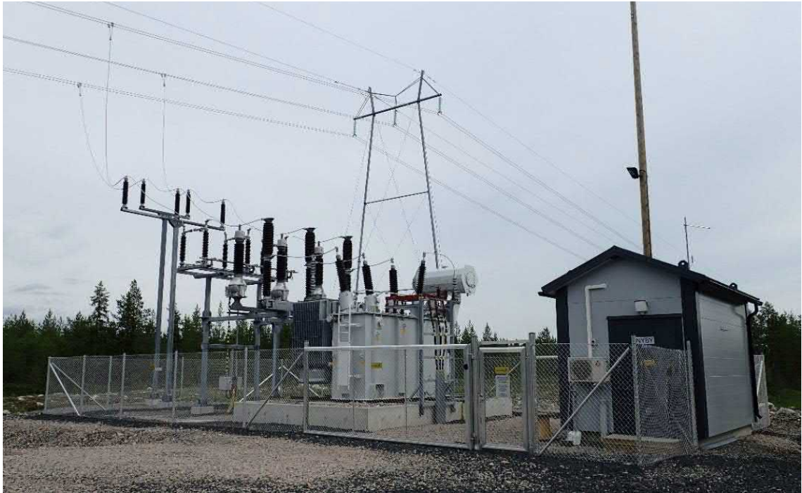
Kuva 2.16. Esimerkki tuulivoimapuiston sähköasemasta.
